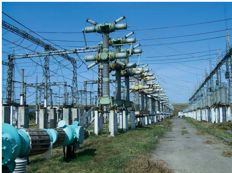
Bild 1 220-kV-Schaltanlage in Kasachstan
