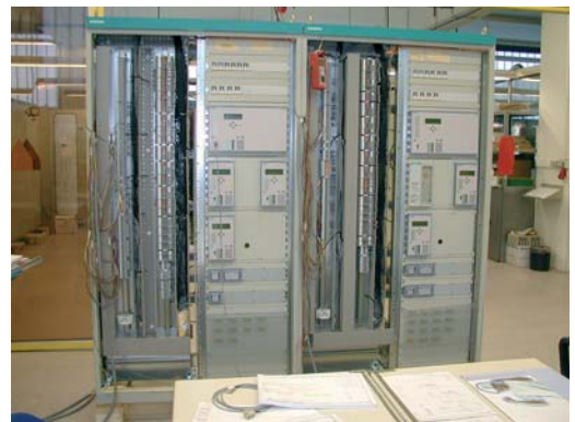
Bild 8 Prüfung der Generatorschutzschranke
