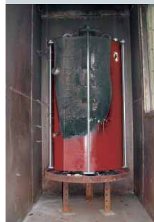
Bild 3 a + b: Sehr gutes Verhalten bei direkter Flammeinwirkung bescheinigt: 1.500-kVA-GEAFOL-Gießharztransformatoren-Prüfling im Prüfinstitut der CESI im Juli 2005 vor (oben) und nach (unten) der Prüfung zum Nachweis der Brandklasse F1 gemäß IEC 600076.
